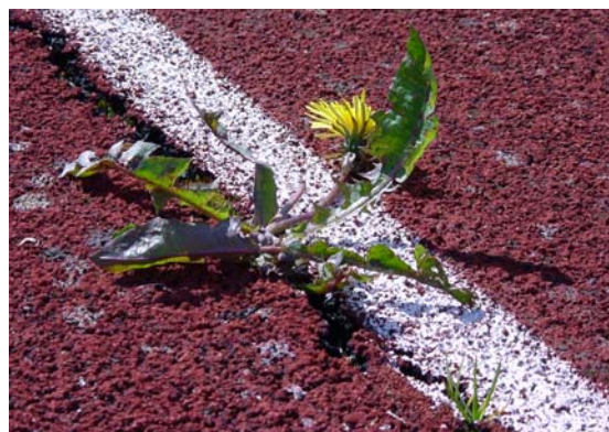
Vegetasjon må ikke få anledning til å etablere seg i dekket.
