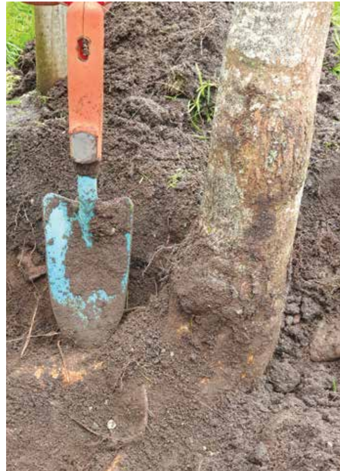
Ved kontroll av plantearbeidet i Gravensteinsgata i Sogndal viste det seg at alle spisslønnene var plantet 10-18 cm for dypt.
